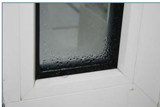
Abb. 3: Tauwasserbildung auf der kalten Fensterscheibe
